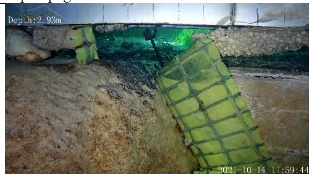
Figure 7 : Défaut structurel à la base du captage (vue sur le marais à l'extérieur depuis l'intérieur)
