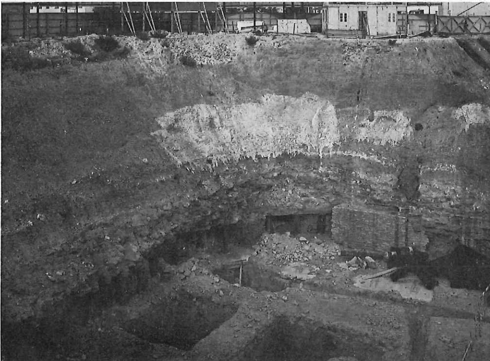
Fig. 8. — Coupure du ciel de carrière par une grande fouille, étalement provisoire sur poteaux en bois avant exécution d'un mur de ceinturage.
