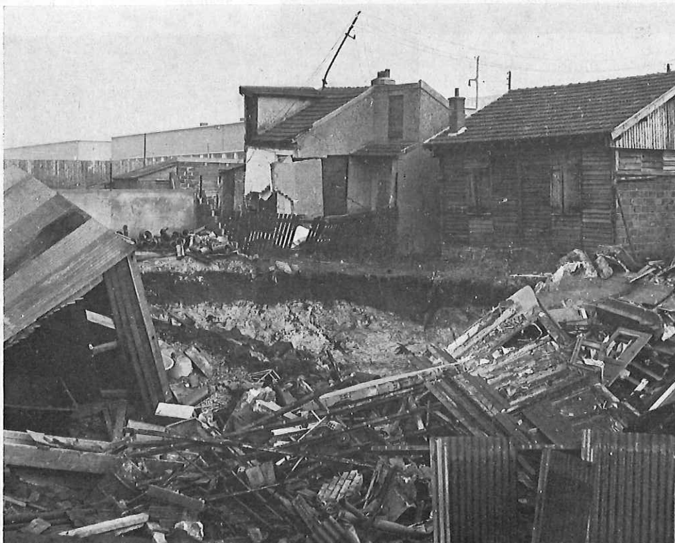
Fig. 6. — Fontis venu à jour. Effondrement des constructions ou désordres.
